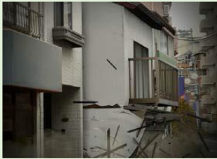
強い揺れによる建物崩壊
