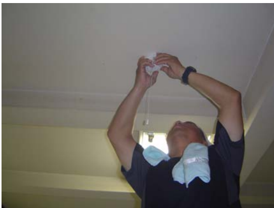
協力者に対するお礼（火災警報器の設置）
