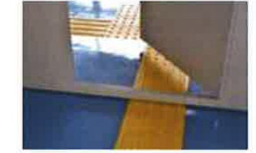
煙の中では防火扉下部のフレームにつまづいてしまうというあらたな気づき
