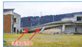
北上川と反対側に倒れている渡り廊下
