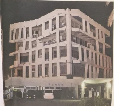
鉄骨コンクリート5層建ての宇土市役所。未明の強い地震で外側の柱が折れ 倒壊状態となった=16日午前4時35分すぎ(丸山正一)
