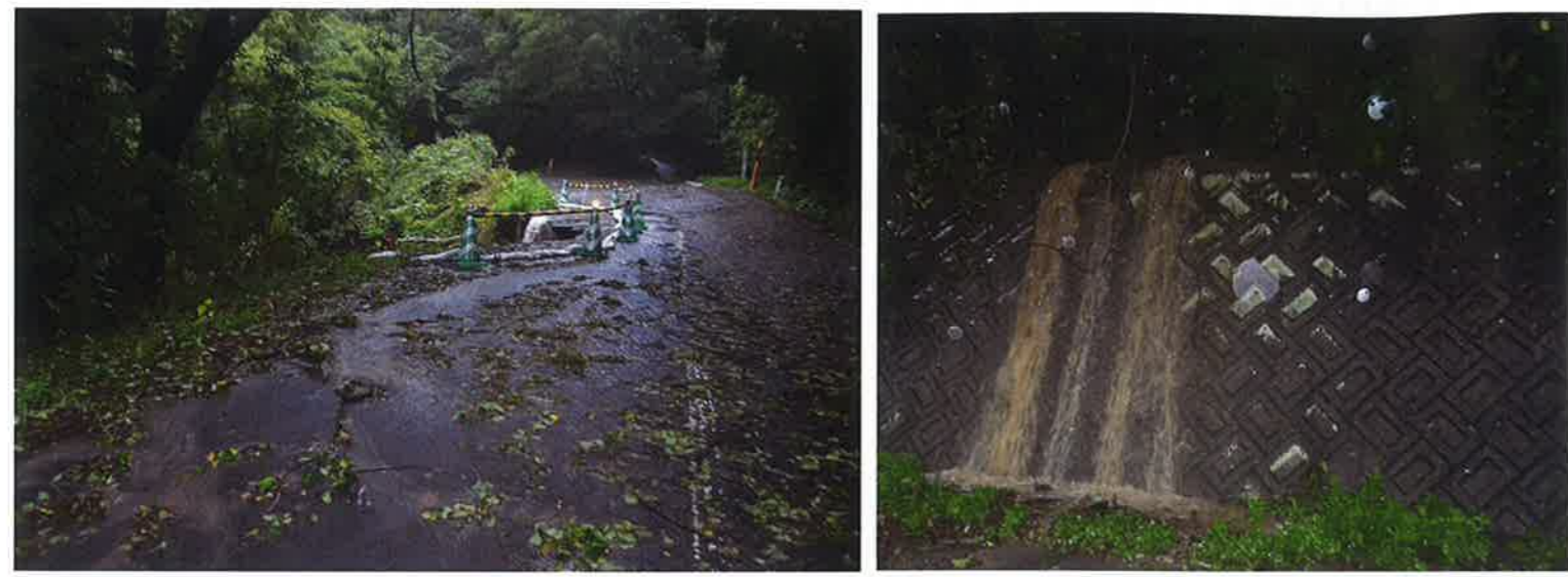
身近な場所で、台風の時に起こっていたこと 県道の路面崩壊、急斜面から流出する土砂 高松市庵治町
